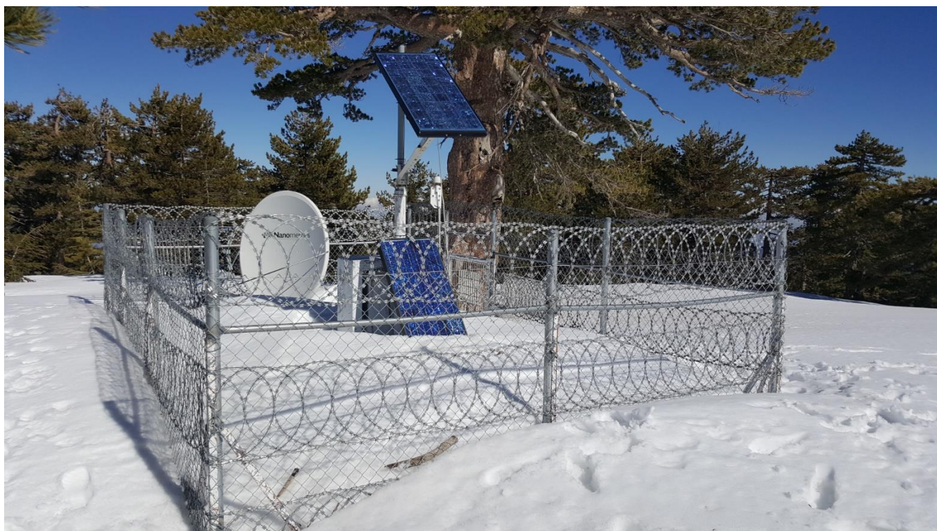
Διάγραμμα 2: Ο νέος σεισμολογικό σταθμός στην περιοχή Τροόδους, ο οποίος εγκαταστάθηκε κατά το 2016 και αποτελεί τον δέκατο χερσαίο σταθμό του νέου Σεισμολογικού Δικτύου της Κύπρου.
