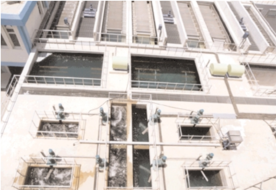
Γενική άποψη των δεξαμενών κροκίδωσης και καθίζησης
