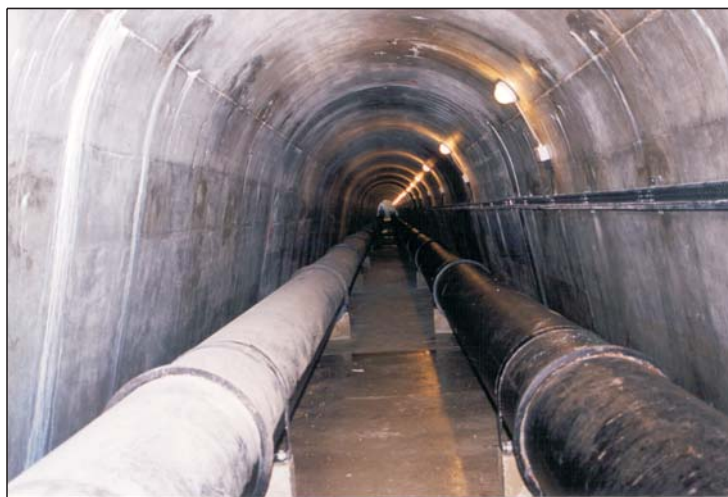
Αγωγοί στη γαλαρία υδροληψίας - Pipework inside draw-off culvert
