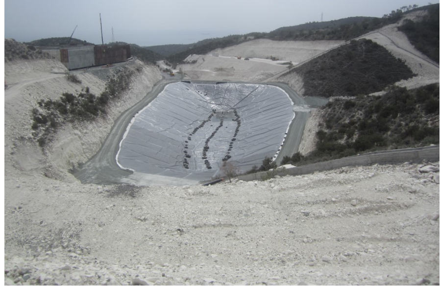
Δεξαμενή (λίμνη) αποθήκευσης
